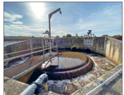
Zuführung von Eisen(III)-chlorid im Verteilerbauwerk Nachklärbecken
