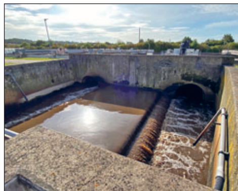
Zuführung von Natriumaluminat Verteilerbauwerk Belegung
