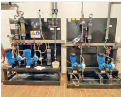
Dosieranlage für Natriumaluminat und Eisen(III)-chlorid mit Dosierpumpen
